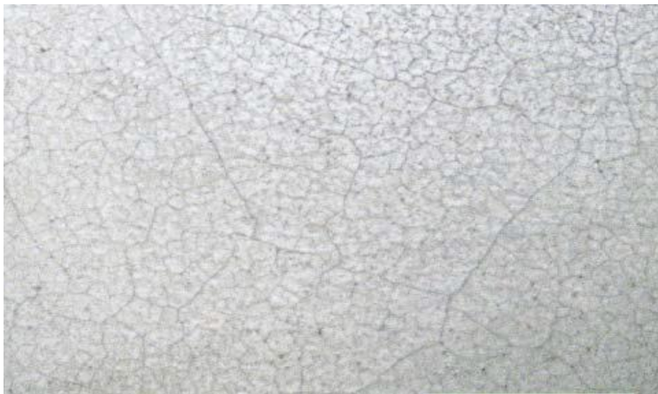
Hình 4: Dạng nứt mặt vật liệu bê tông nhựa vừa kết hợp
