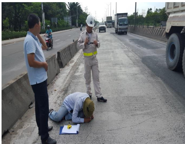
Kiểm tra vết nứt mặt
